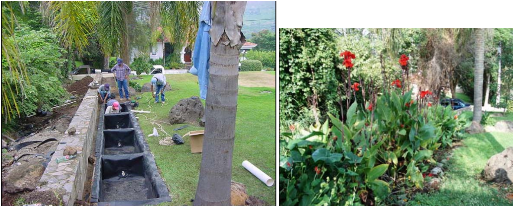
Aspecto de un humedal artificial operando en una casa habitación en Guadalajara (México). Las aguas tratadas son rehusadas para el riego del jardín.
