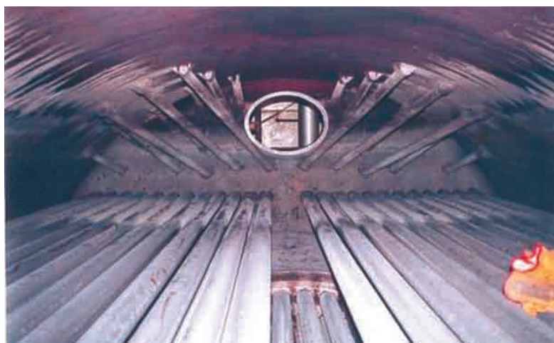
Foto 3.5. Efecto de los sólidos disueltos en el nivel de agua de la caldera de vapor.
