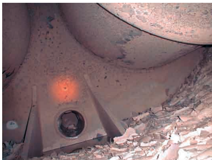
Foto 3.2. Ejemplo de acumulación de las incrustaciones en fondo de caldera.
