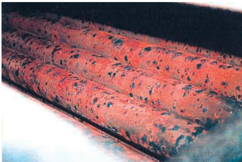
Foto 3.3. Ejemplo de corrosión por pitting en tubos de humo.
