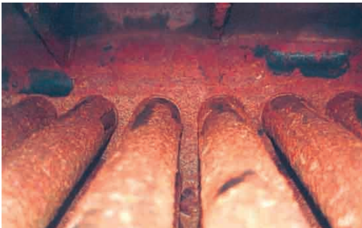
Foto 3.1. Ejemplo incrustaciones en caldera de vapor.
