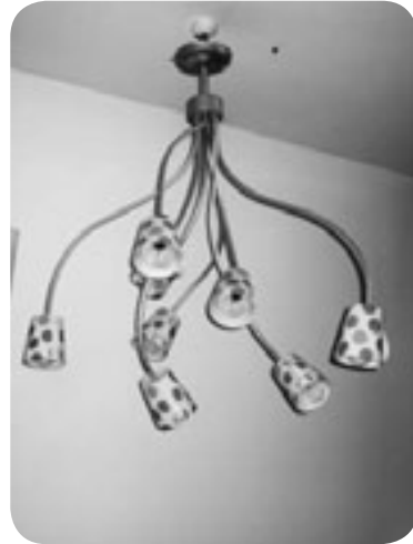
Prototipo Instalado Fuente: Lucrecia Rodríguez
