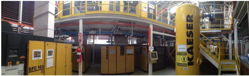
Figura 20. Sala de compresores Colgate-Palmolive, Guatemala Fuente: Propia
