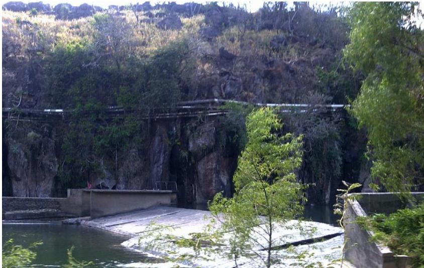
Figura 16. Vulnerabilidad de la línea de conducción a derrumbes y deslizamientos, debido a la alta pendiente por donde pasa la tubería
