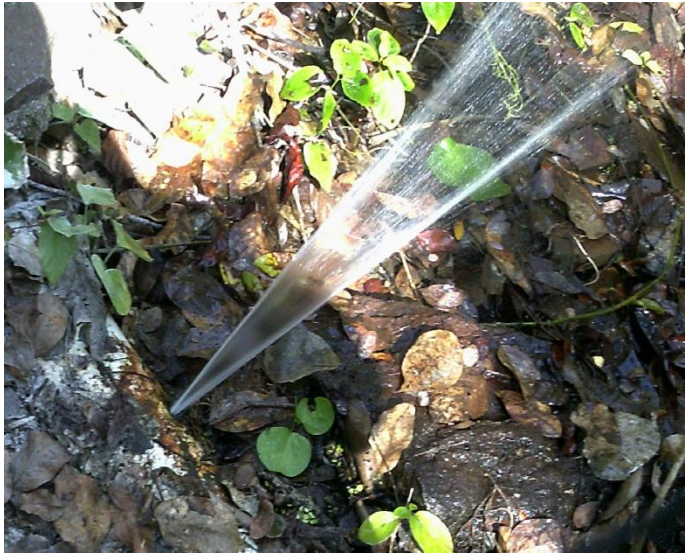
Figura 27. Respiradero de agua mal establecido, debido que el diámetro es demasiado grande
