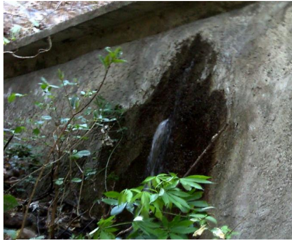
Figura 12. Grietas en las obras de captación del sistema de abastecimiento
