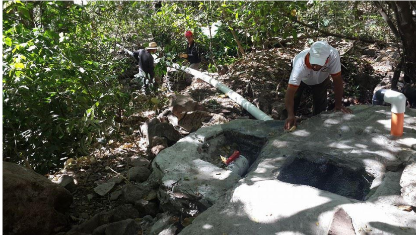
Figura 18. Cambio de un tramo de la tubería en mal estado de la línea de conducción del sistema de abastecimiento
