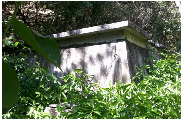
Figura 20. Estado de los tanques (existen fugas en los tanques donde pueden ser contaminados por medio del contacto animal o humano)
