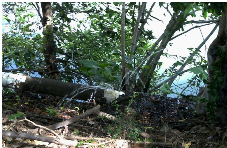
Figura 17. Fuga de la línea de conducción del sistema de abastecimiento causado por un derrumbe de peña
