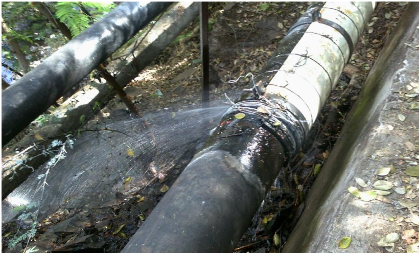
Figura 26. Fuga que provoca el mayor desperdicio de agua del sistema de abastecimiento del municipio de Asunción Mita
