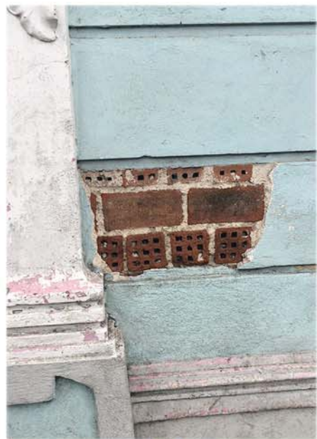
DAÑOS EN MURO
