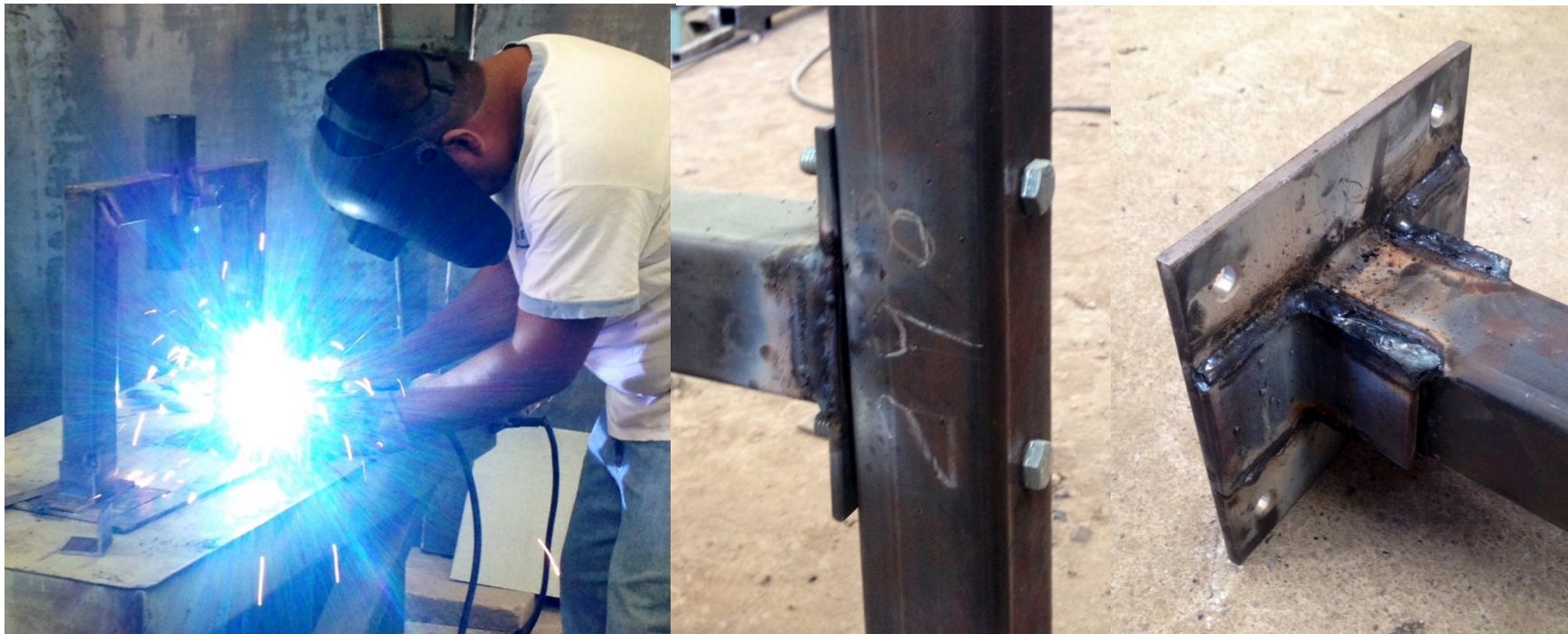
Imagen 215. Soldadura de piezas que integran el sistema entero; comprobación de encajado de piezas ya soldadas. Fuente: propia
