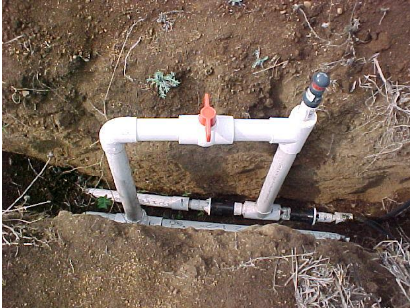
Figura. 13 Detalle de instalación manifold (válvula de esfera y VBK-1) Fuente: El Autor
