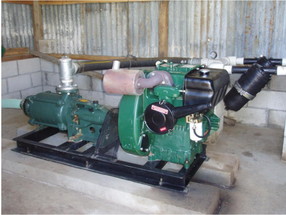
Figura. 23 Vista del Equipo de bombeo instalado, Finca San Bernardino. Fuente: El Autor.
