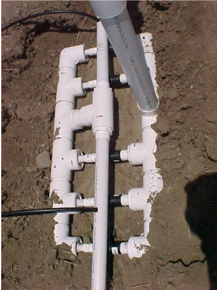
Figura 18. Detalle de instalación de batería reguladora de presión. Fuente: El Autor.
