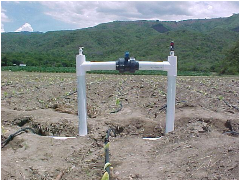
Figura. 14 Detalle de instalación de manifold (válvula de esfera, válvula de aire, chorro) Fuente: El Autor.
