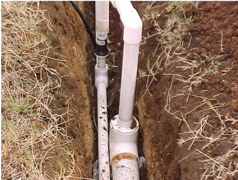
Figura 12. Detalle de Instalación de sistema de riego por goteo Fuente: El Autor.
