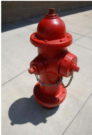
Imagen 17: Hidrante contra incendios. Fuente:/www.coiim.es
