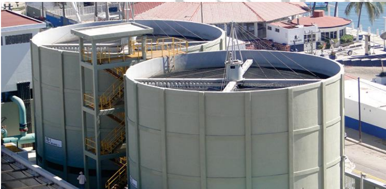
Imagen No. 28. Sedimentadores primarios. Fuente: http://jumapam.gob.mx/planta-tratadora-el-creston/ . Fecha de consulta: 23 de noviembre de 2016
