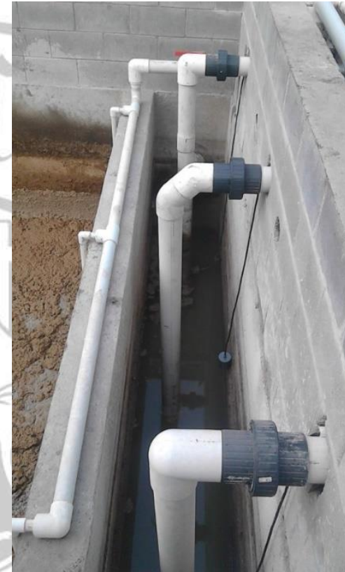
Imagen No.19. Estación de bombeo. Fuente: Planta de Tratamiento de Aguas Residuales Ente Generador Empacadora Toledo S.A. Amatitlán. Ing. Jorge Mariano Menéndez Grout, Grupo Verde Caribe, S.A. Fecha de consulta: 7 de marzo de 2017.
