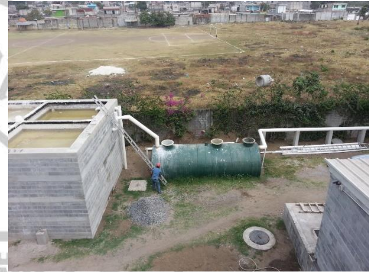
Imagen No. 21. Tanque de desinfección. Fuente: Planta de Tratamiento de Aguas Residuales Ente Generador Empacadora Toledo S.A. Amatitlán. Ing. Jorge Mariano Menéndez Grout, Grupo Verde Caribe, S.A. Fecha de consulta: 7 de marzo de 2017.
