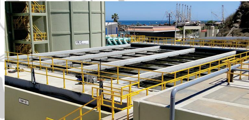
Imagen No. 27. Tratamiento Primario Fuente: http://jumapam.gob.mx/planta-tratadora-el-creston/ . Fecha de consulta: 23 de noviembre de 2016
