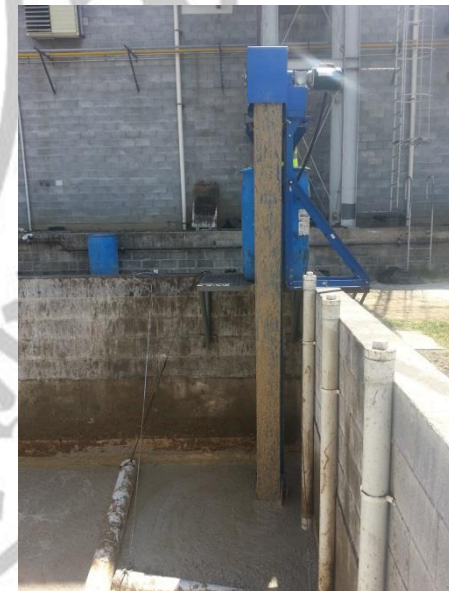
Imagen No. 18. Tanque trampa de grasa. Fuente: Planta de Tratamiento de Aguas Residuales Ente Generador Empacadora Toledo S.A. Amatitlán. Ing. Jorge Mariano Menéndez Grout, Grupo Verde Caribe, S.A. Fecha de consulta: 7 de marzo de 2017.
