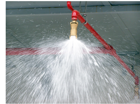
Imagen 38. Sistema de extinción
