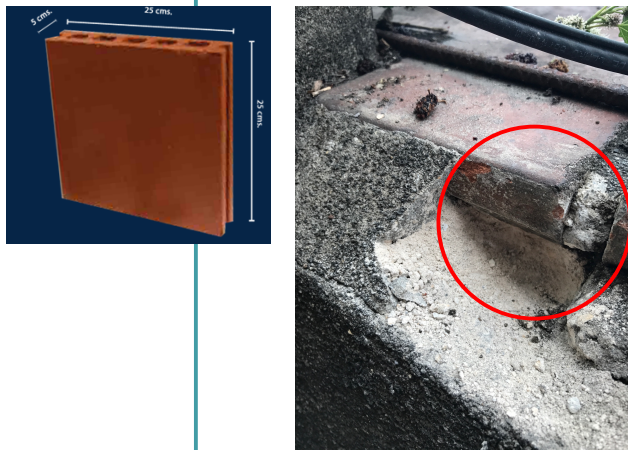
Ilustración 34 Cubierta de techo, baldosa de arcilla cortada en dos partes su espesor. Fragmentando su cámara de aire interno. Fuente: Propia
