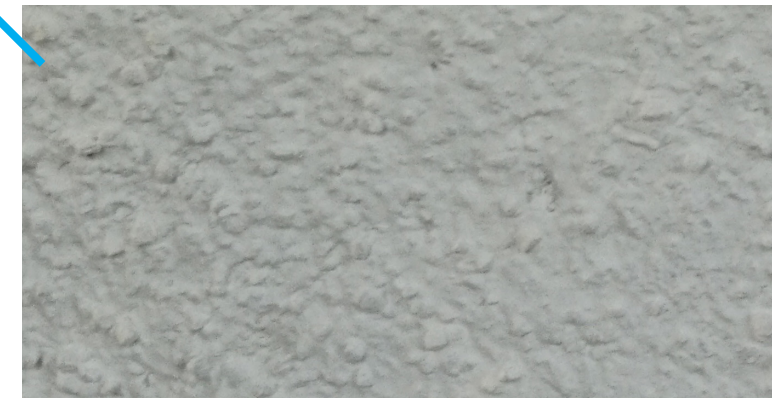
Remolineado medio Fotografía: Javier García
