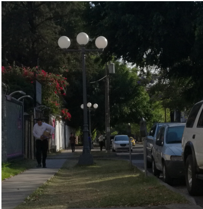
Detalle luminarias públicas Fotografía: Javier García
