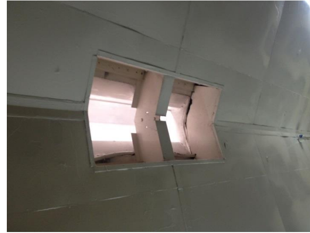
Imagen No. 50: Uso de ventilación cenital no es suficiente. Fuente: Propia.
