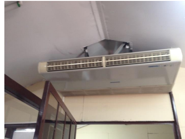
Imagen No. 51: Uso de aire acondicionado por falta de ventilación natural. Fuente: Propia.
