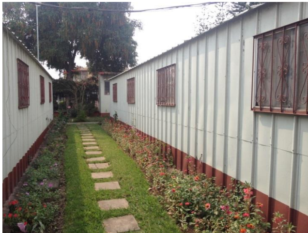
Imagen No. 53: Ventilación inapropiada. Fuente: Propia.
