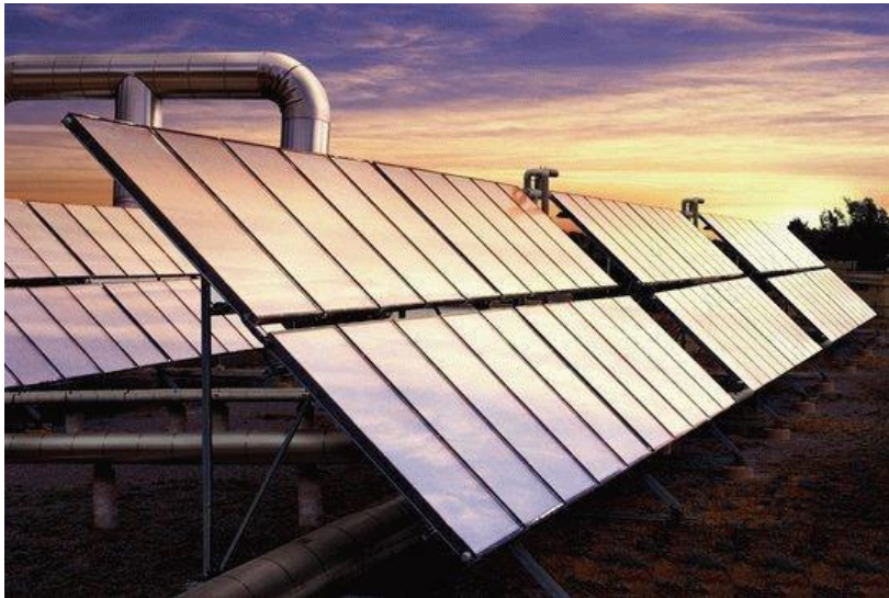
Imagen No. 66: Energía solar fotovoltaica.
