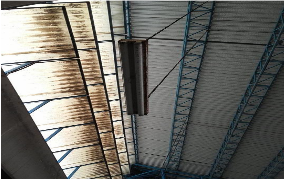
Falta de mantenimiento en la iluminación dentro de las instalaciones.
