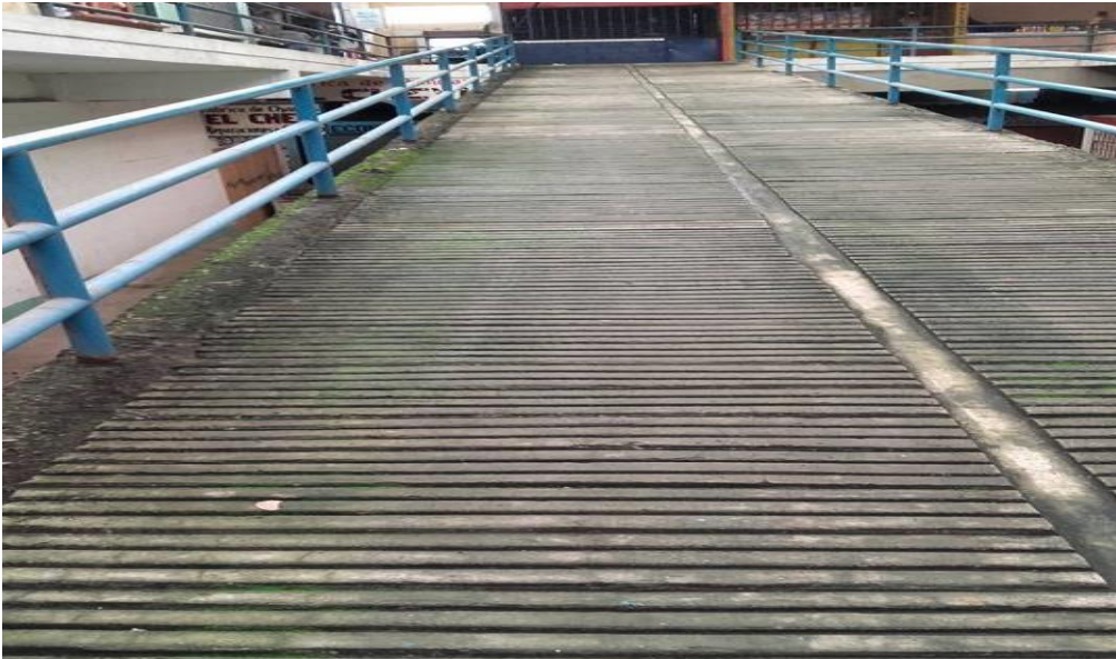
Piso resbaladizo, a causa del techado dañado.
