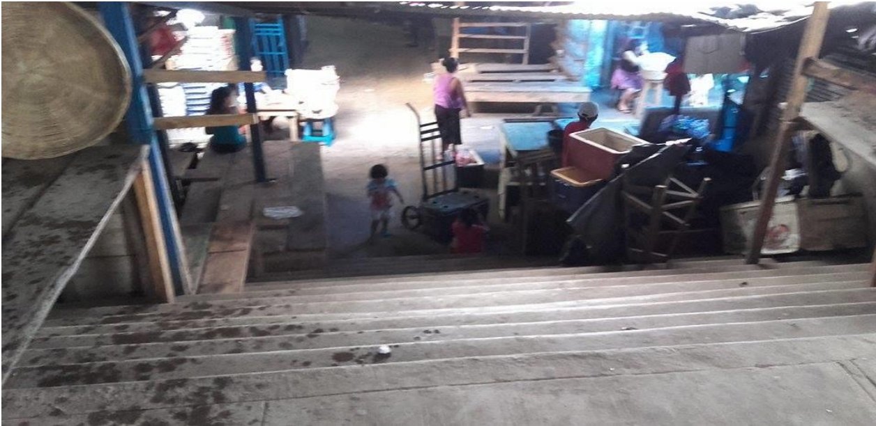
Falta de pasamanos en las gradas.
